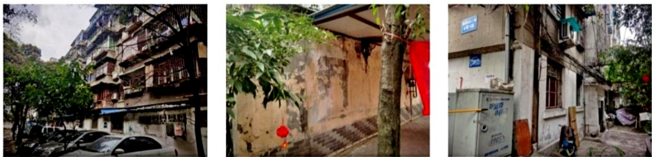
图1 抚琴路西北接社区外墙污损严重(图片来源:作者自摄)
